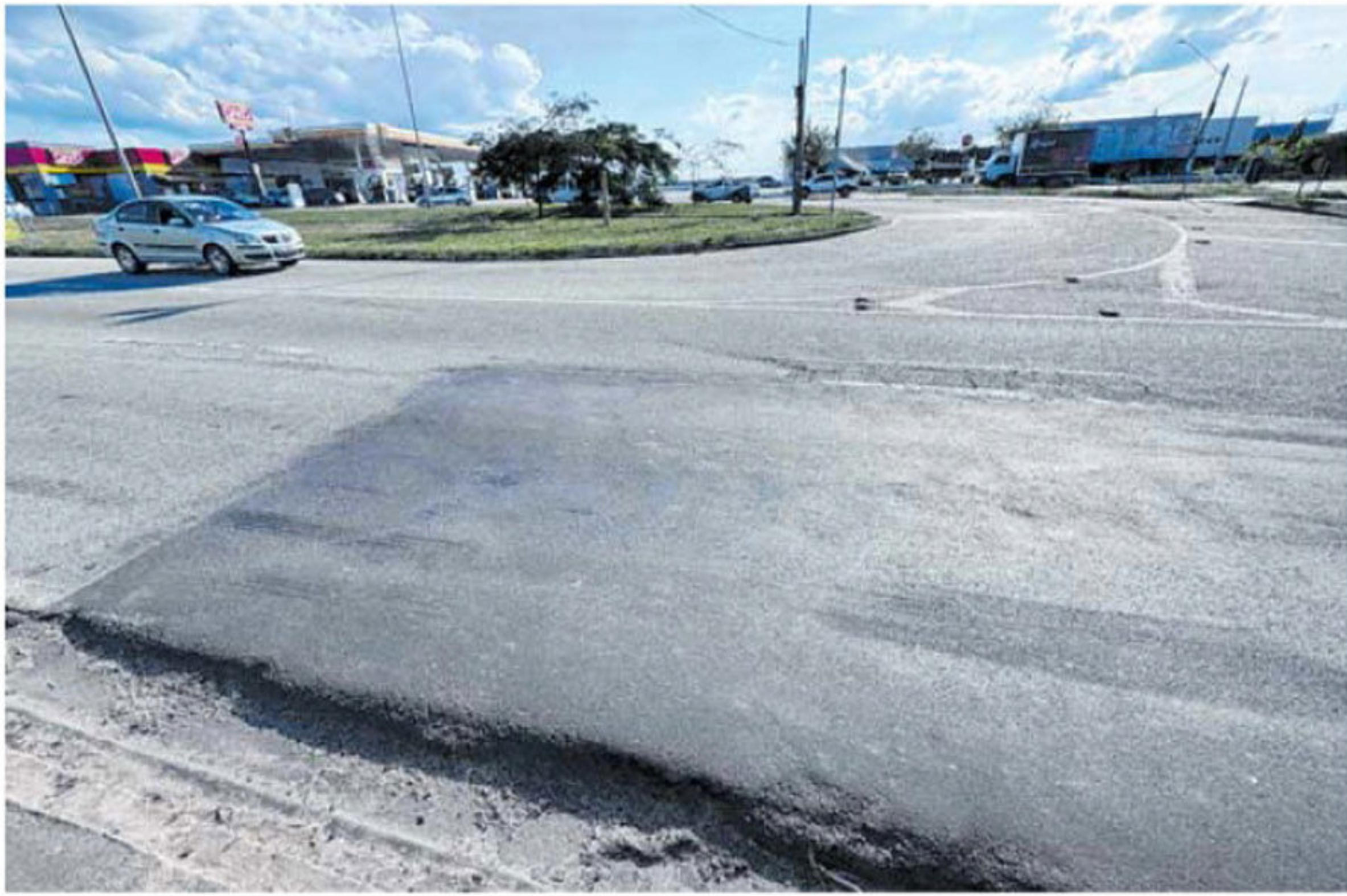
Remendos provocam desníveis na pavimentação de vias que têm trânsito intenso
