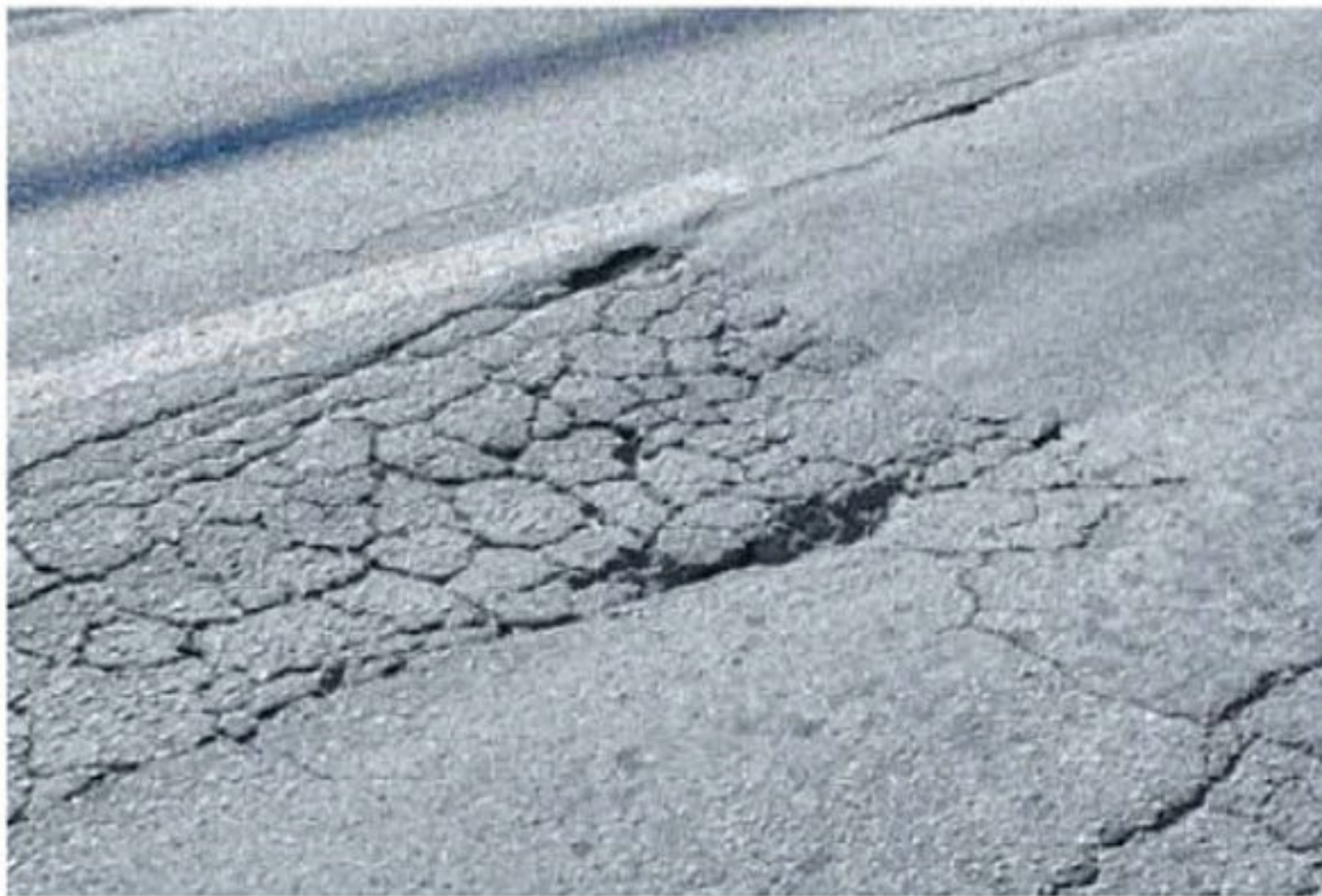
Pista com buracos e fissuras é perigosa para motociclistas
